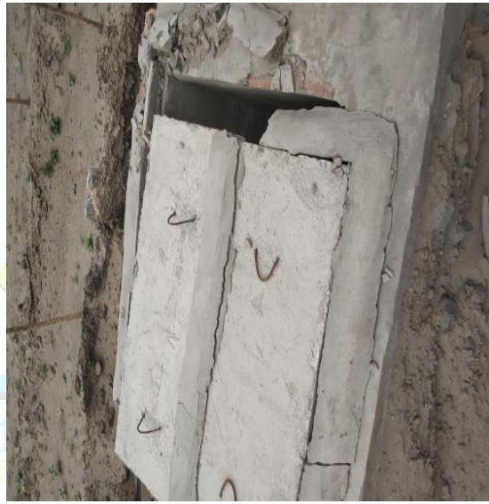
渗滤液缓冲收集池
